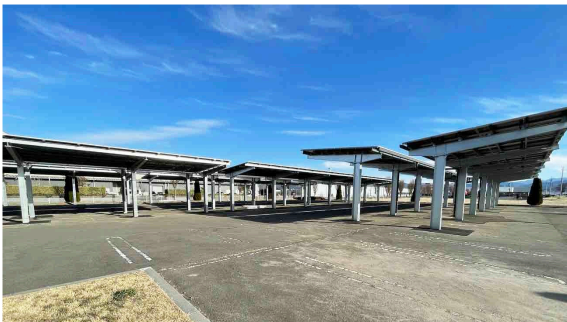
[イクトの施工事例] 工場の駐車場にソーラーカーポートを設置（DC容量245.11kW）
